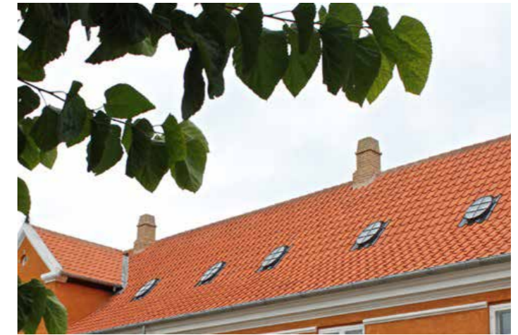
9-ziegelige ovale, gekoppelte Dachfenster, Dantegl, Flügeldachziegel von Monier auf Prinsens Gård, Frederiksberg Have.
